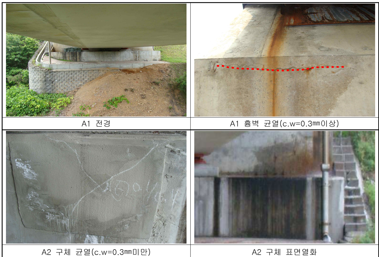
【사진 3.3】 교대 손상현황
