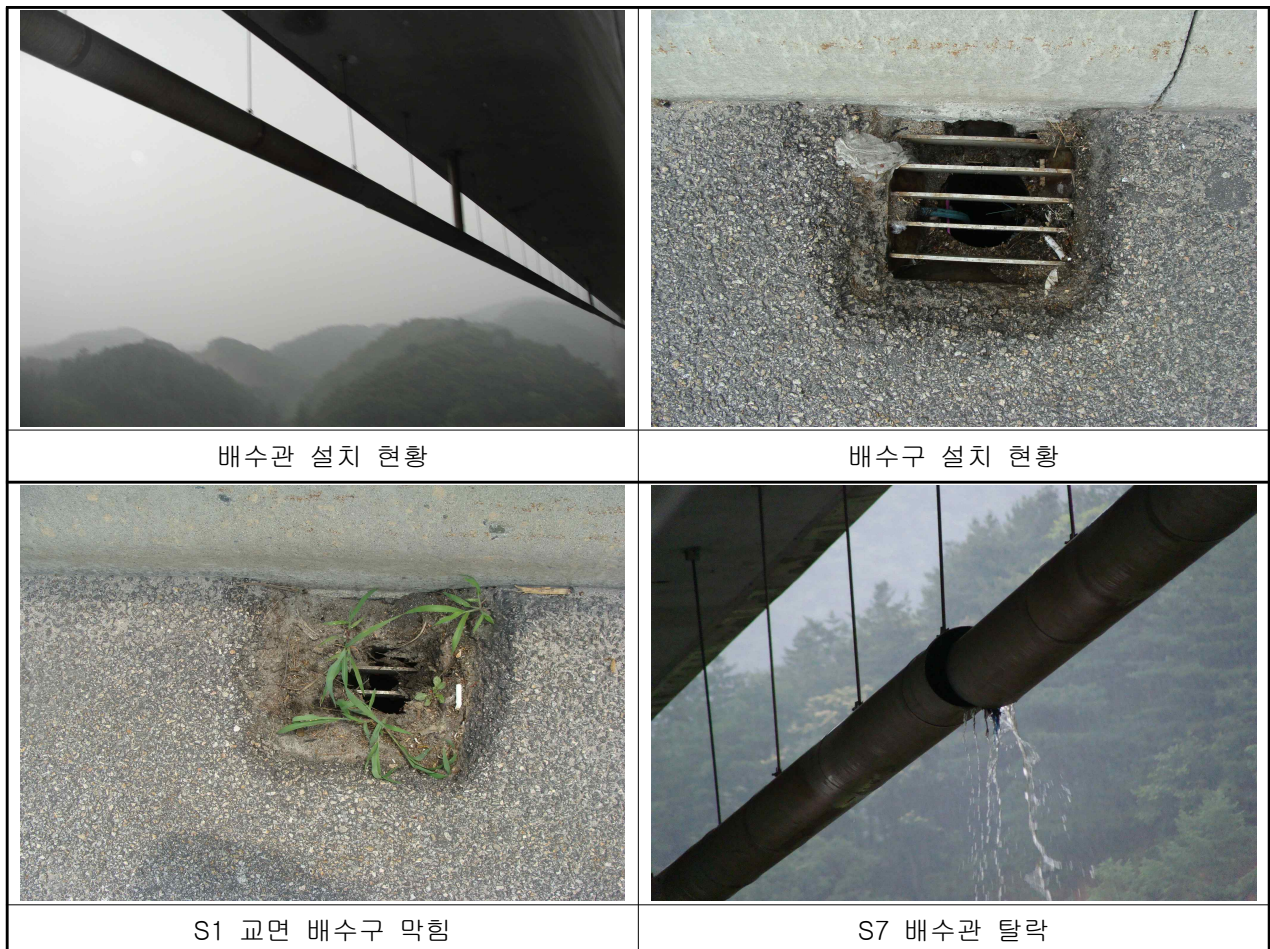
【사진 3.10】 배수시설 손상 현황
