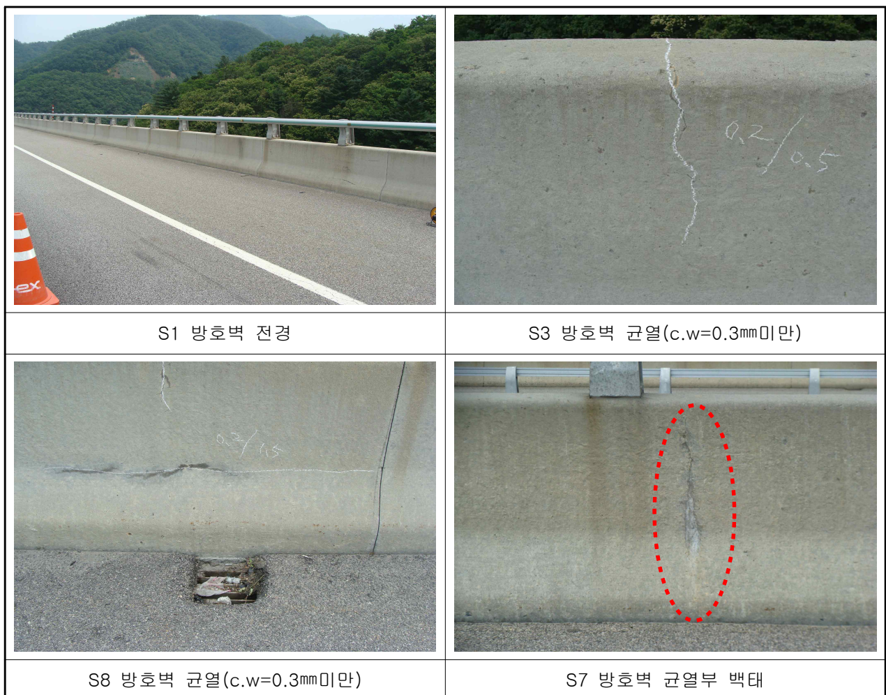
【사진 3.11】 방호벽 손상 현황
