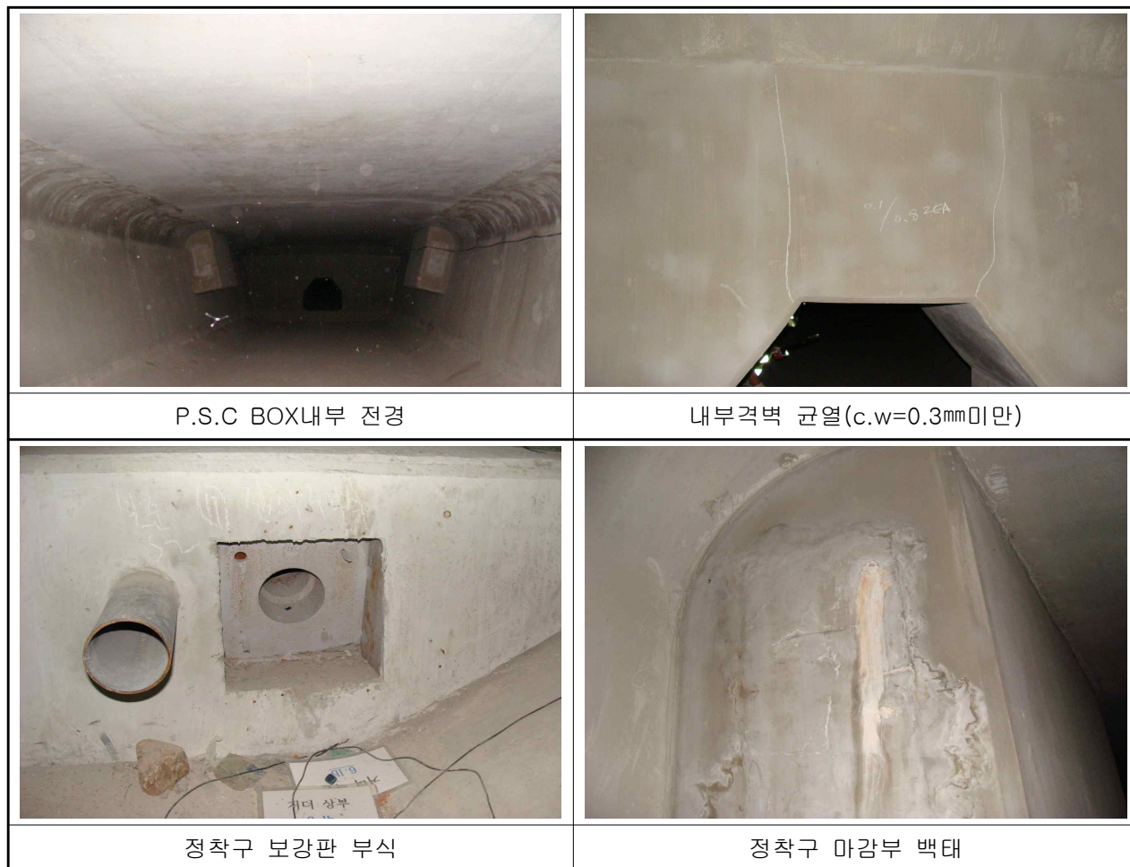
【사진 3.2】 P.S.C BOX내부 손상현황
